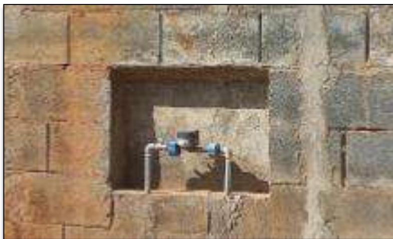
Figura 72 - Hidrômetros - Distrito de São Bartolomeu de Minas.
