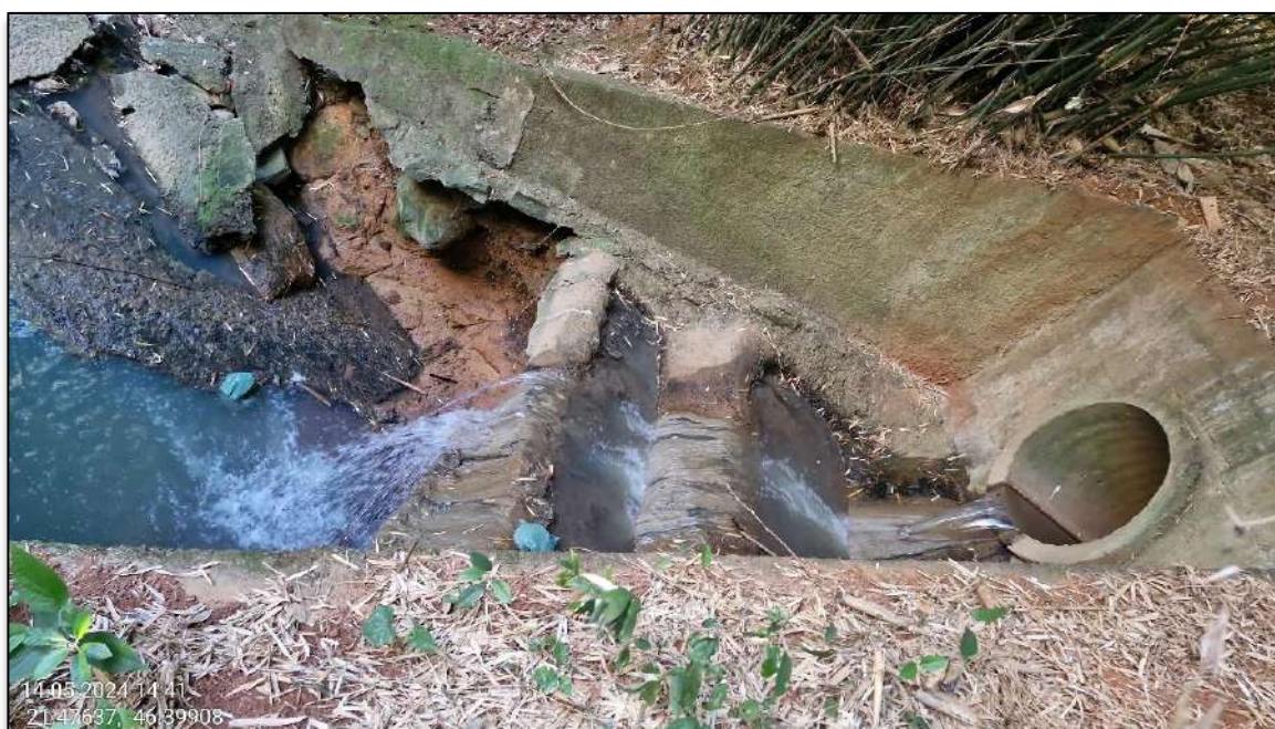
Figura 82 - Ponto de descarte inadequado de esgoto - Cabo Verde/MG.
