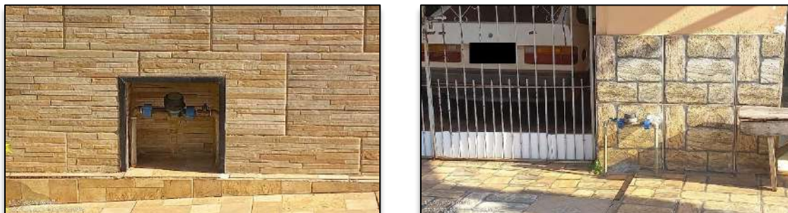
Figura 78 - hidrômetros - Distrito de Serra dos Lemes.
