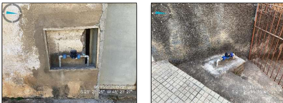
Figura 66 - Hidrômetros - Cabo Verde/MG.
