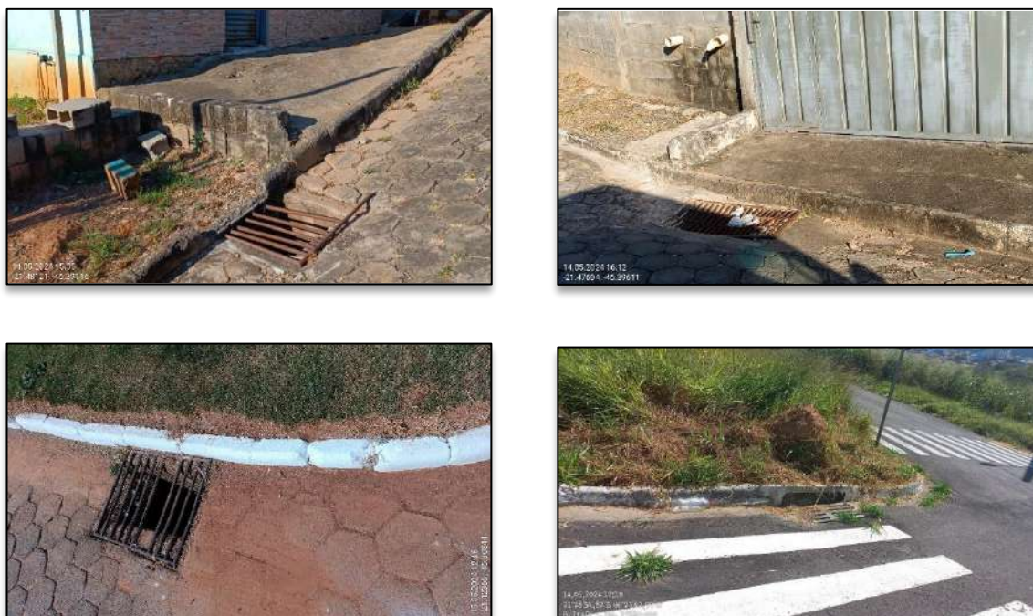
Figura 101 - Irregularidades encontradas no sistema de microdrenagem do município de Cabo Verde/MG
