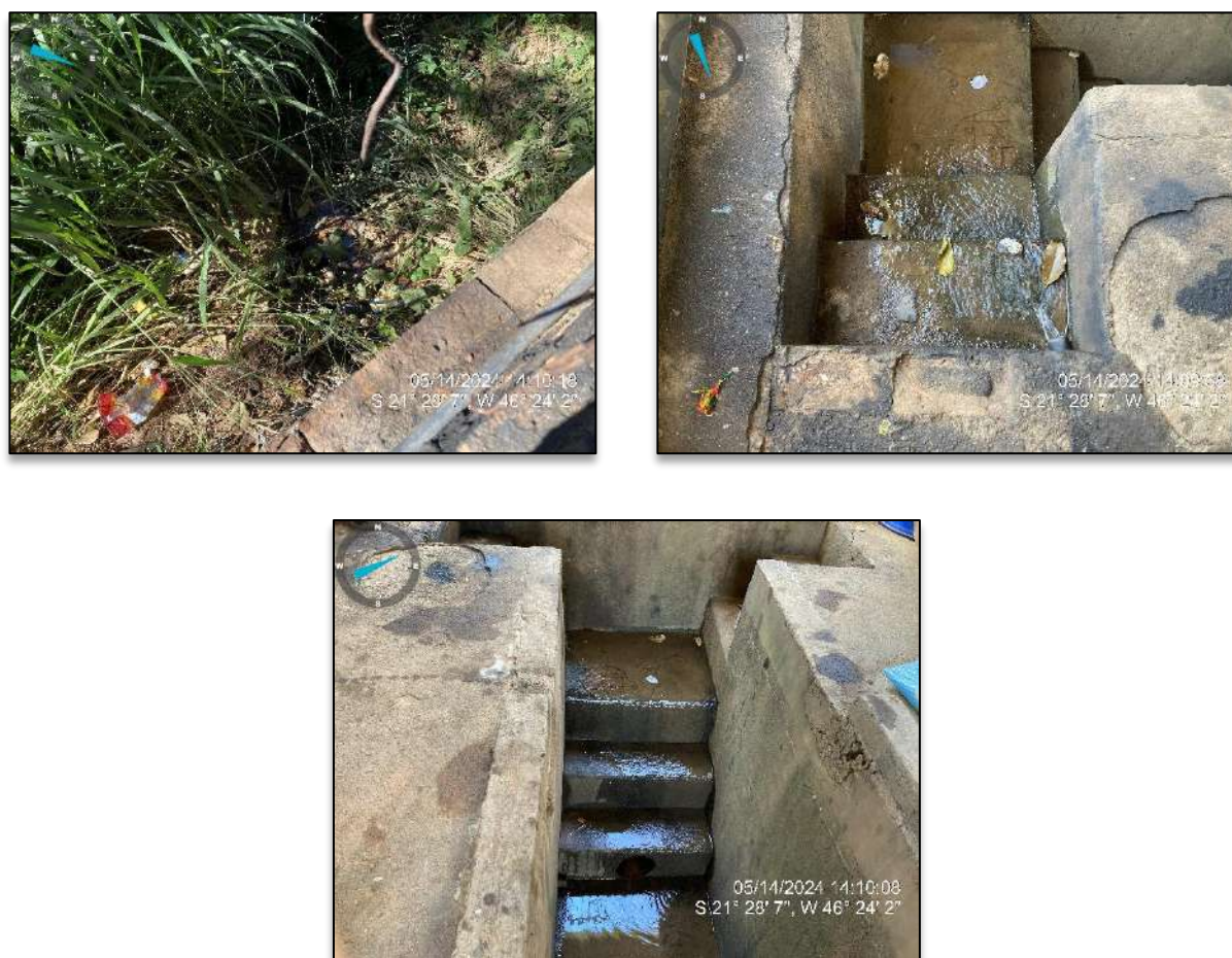
Figura 103 - Lançamento da água utilizada na lavagem dos veículos da prefeitura (Almoxarifado) no Córrego Assunção.
