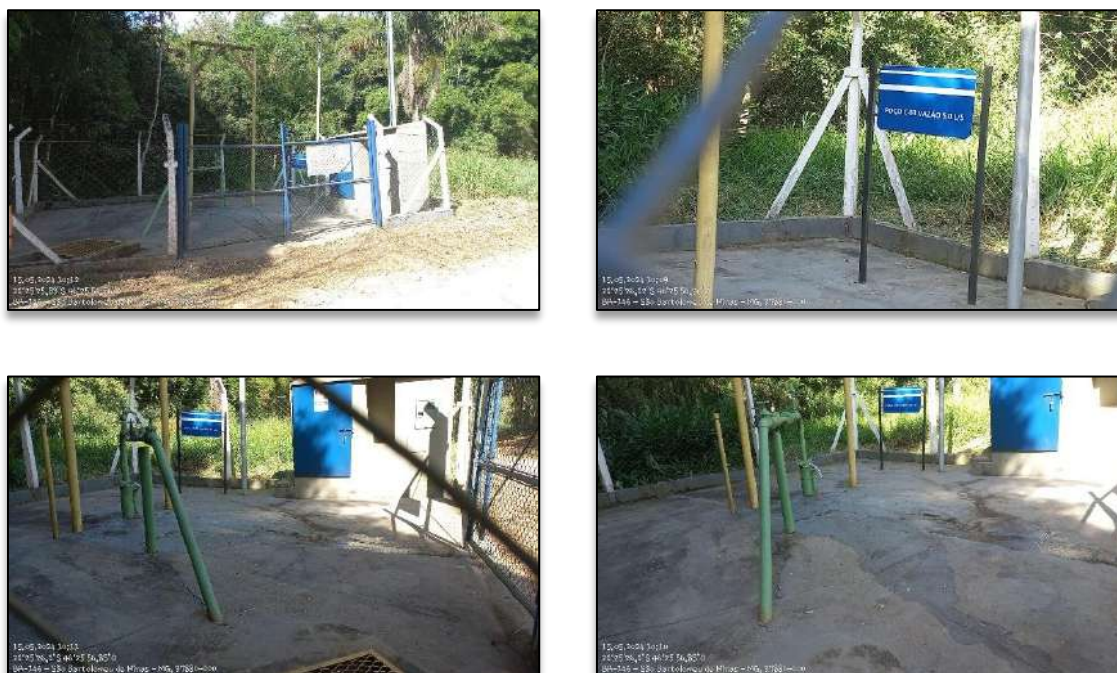
Figura 69 - Poço C-03 - Distrito de São Bartolomeu de Minas.
